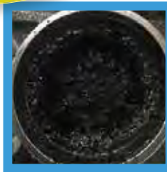
廃油タンク内 オイルスレッジ
